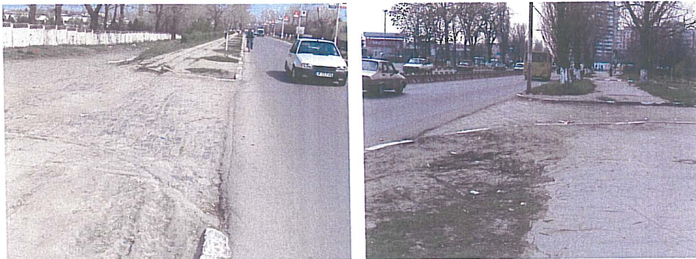
Fig 5,6 – Degradari ale trotuarelor.
