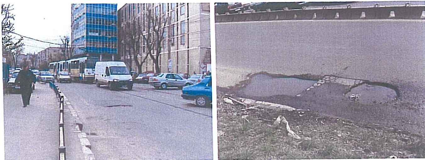
Fig 3,4 – Degradari ale sistemului rutier.
